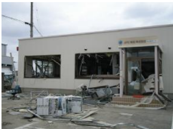
事務所の様子（地震発生直後）
